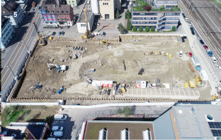
4 Spundwand mit Stahlspreiung, Ersatz- neubau BBZ, Zürich / 5 Planung und Ausführung einer dichten Baugrube mittels Spundwand, Neubau JED, Schlieren ZH/ 6 Spundwand mit Austauschbohrungen, Uptown Basel, Ariesheim BL
